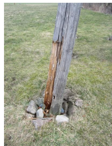
Bild 3. Märgsprickor och rötskada.
