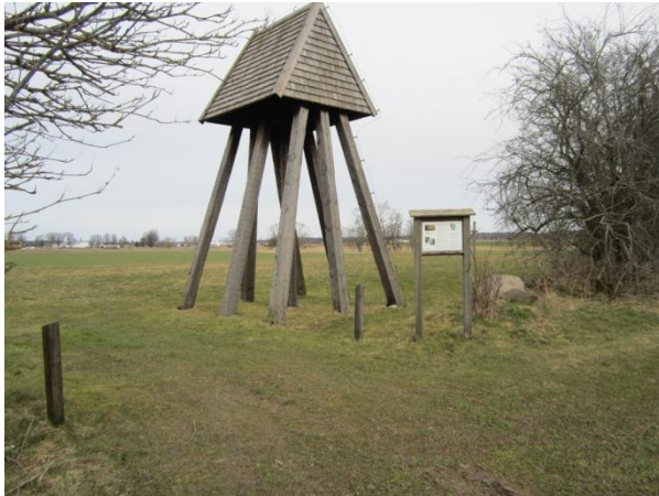
Bild 1. Klockstapelns innan åtgärd 25 mars 2015.
