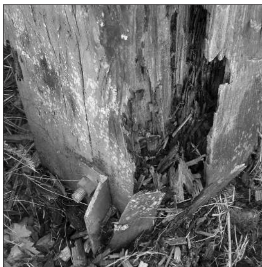
Ett av de kraftigt rötskadade benen. Foto: Elisabeth Göthberg
