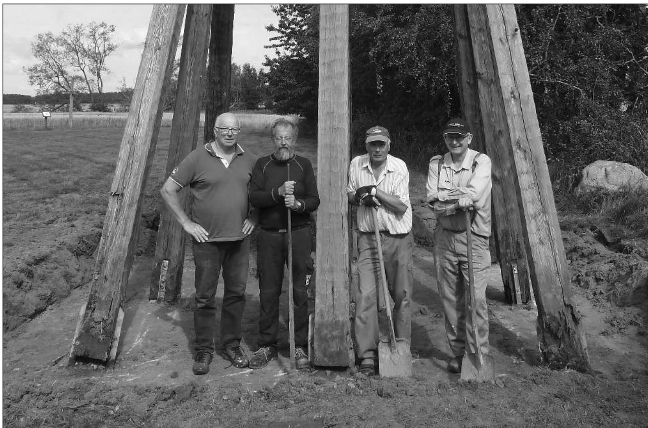
Fundamentet är frilagt. Fr. v. Ingemar Karlsson, Kjell Skogsberg, Jan Rönnholm och Truls Wiberg. De två benen som är värst rötskadade ses ytterst. Foto Elisabeth Göthberg.
